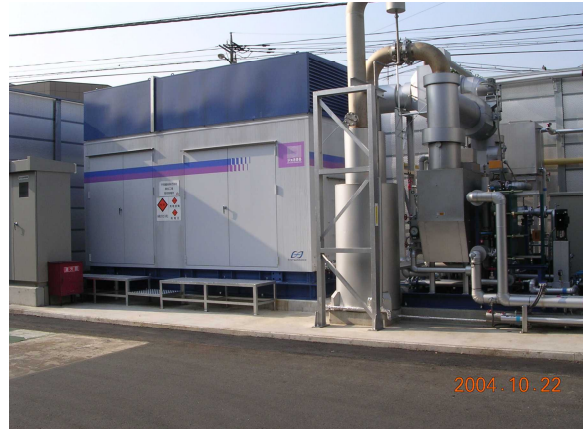
ガスージェネレーション
