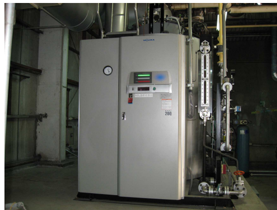
高効率ガス焚きボイラ
