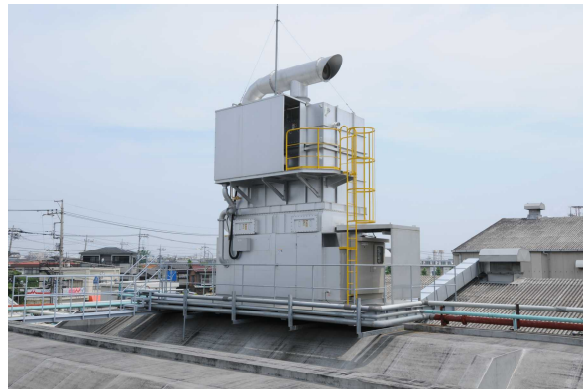
蓄熱式排ガス浄化装置
