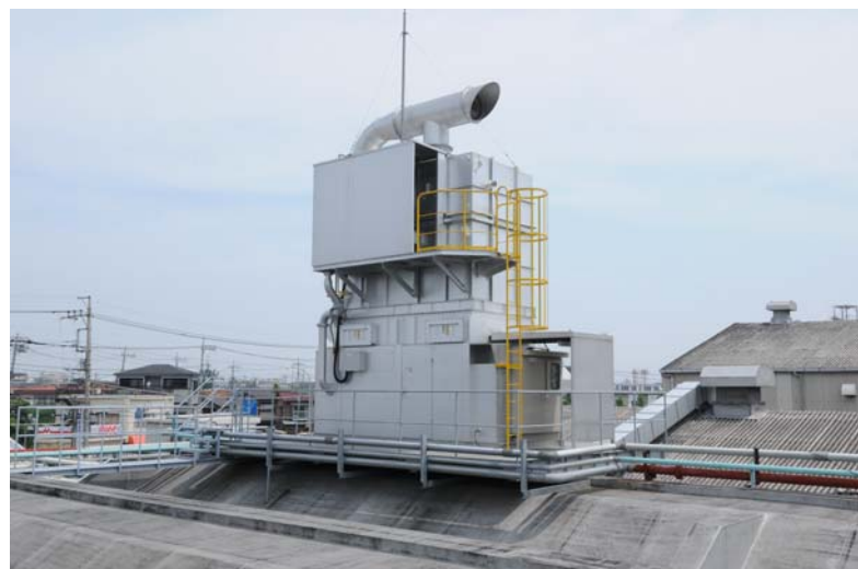
蓄熱式排ガス浄化装置
