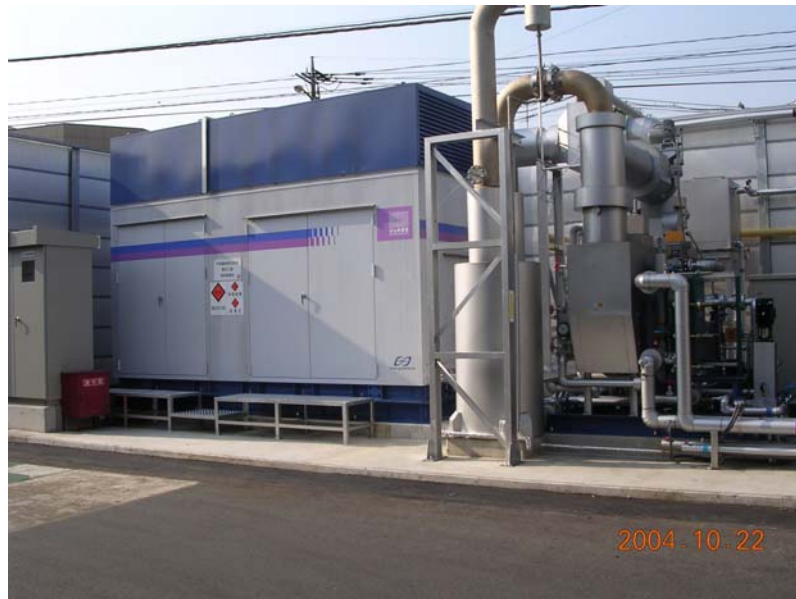
ガスコージェネレーション
