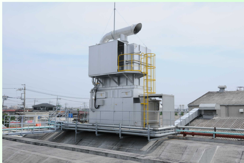
蓄熱式排ガス浄化装置
